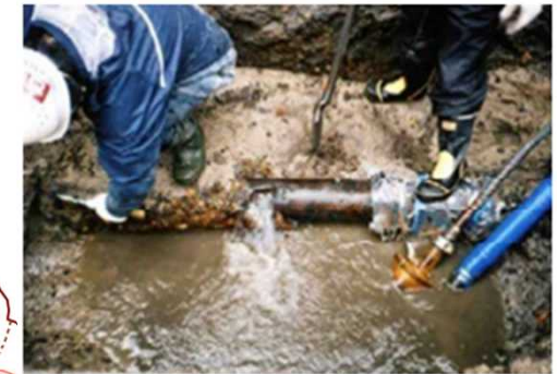
水道管老朽化による漏水
