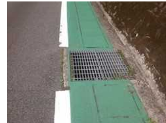
⑦側溝の滑り止め
