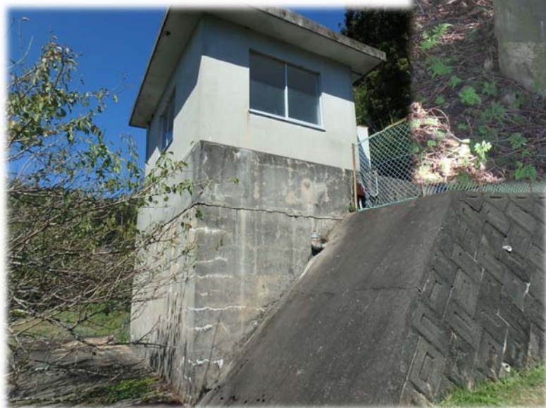
◆北山低区配水池◆
