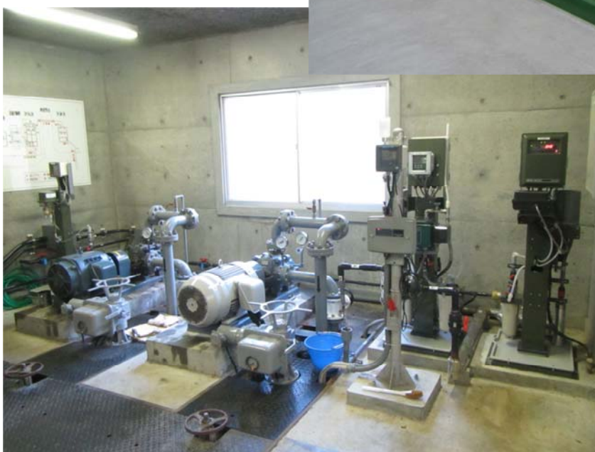
◆久田見浄水場 水質検査設備◆
