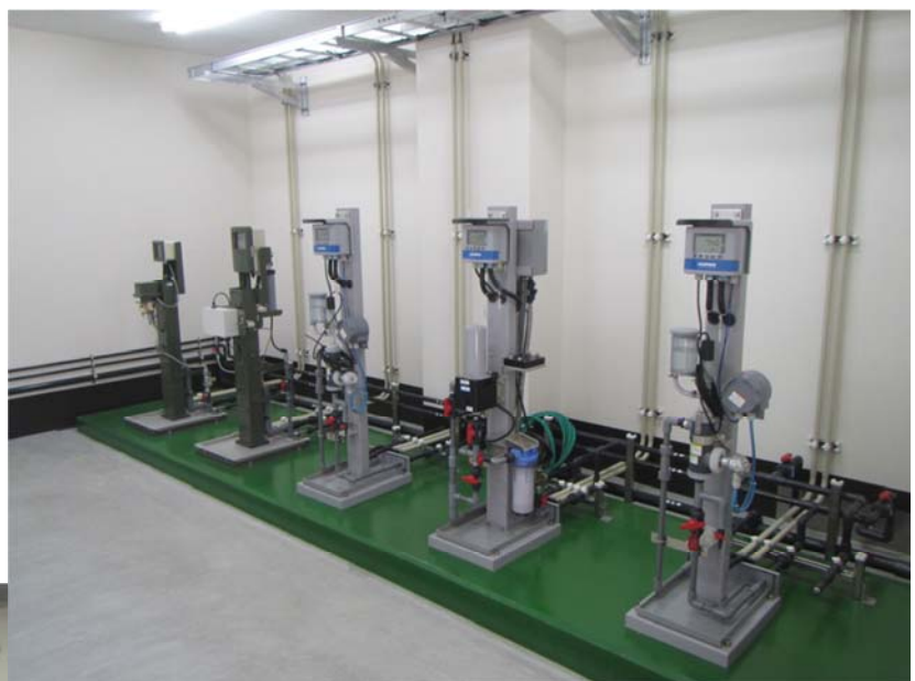
◆上飯田浄水場 水質検査設備◆
