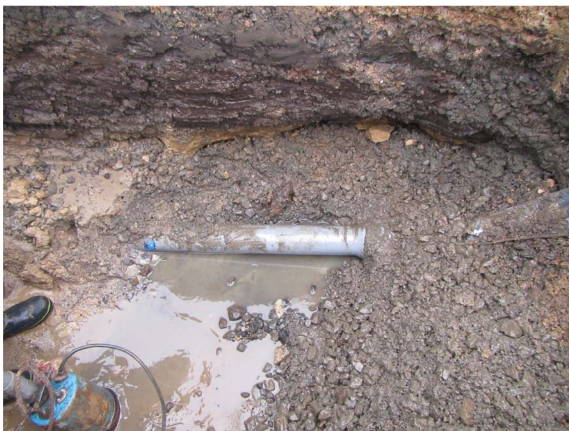
◆管路漏水被害◆
