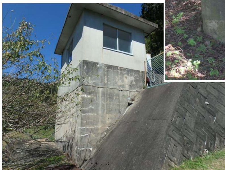
◆北山低区配水池◆
