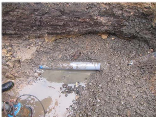
◆管路漏水被害◆
