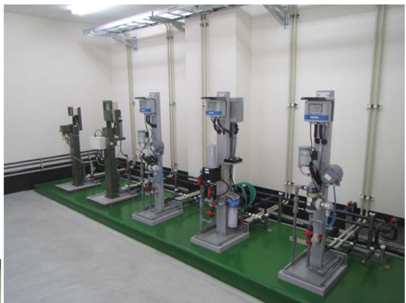
◆上飯田浄水場 水質監視設備◆
